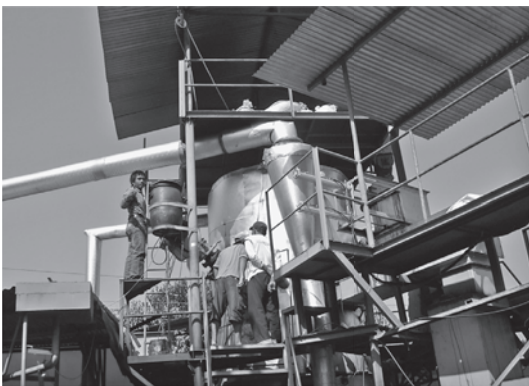
写真 1 実証テストプラント（135kW）のガス化炉 / 再生塔
